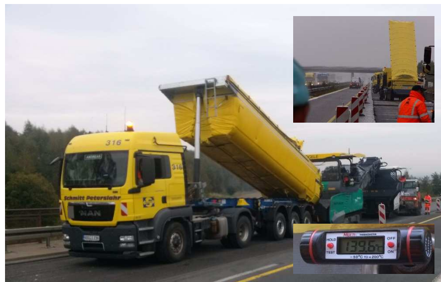
Mischguttransport mit Thermomulde, Einbau mit bis zu 2x Beschicker und Fertiger für geringe Stillstandszeiten
